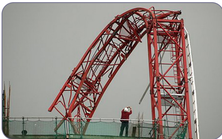
شکل ۹-۷. سقوط بوم جرثقیل برجی در زرتدام هلند
