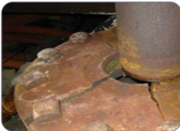
شکل ۱۱-۶ آسیب به اتصالات در اثر پدیده ضربه قوچ
