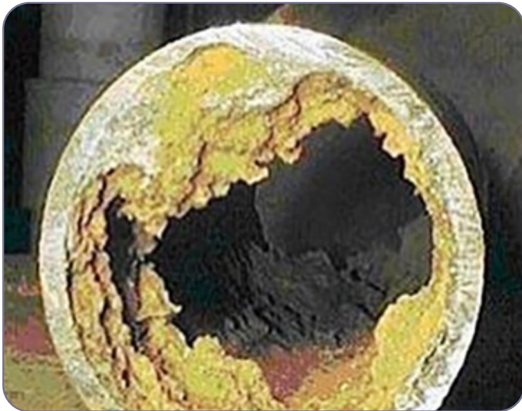
شکل ۳-۴ خوردگی حفره‌ای ناشی از اکسیژن
