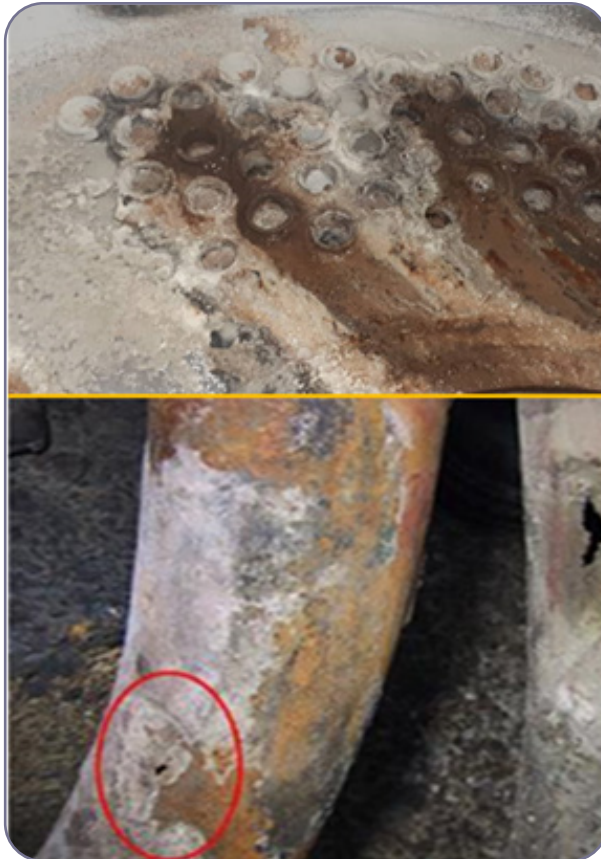
شکل ۱۷-۶ سوراخ های روی لوله ناشی از عدم کنترل رشد خوردگی در آب
